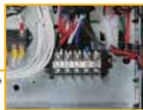
Клемная колодка для подключения питания наружного блока
